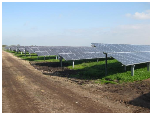
Bürgersolarpark Ellhöft – 2,03 MWp
